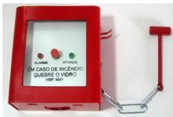
ALARMES DE INCÊNDIO
